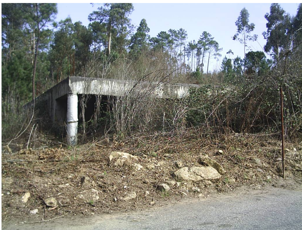
Fotografia 3 - Estrutura em betão, associada a uma construção inacabada, afectada pelo Ramo B do Nó de Sandim e pela própria via (A41)
